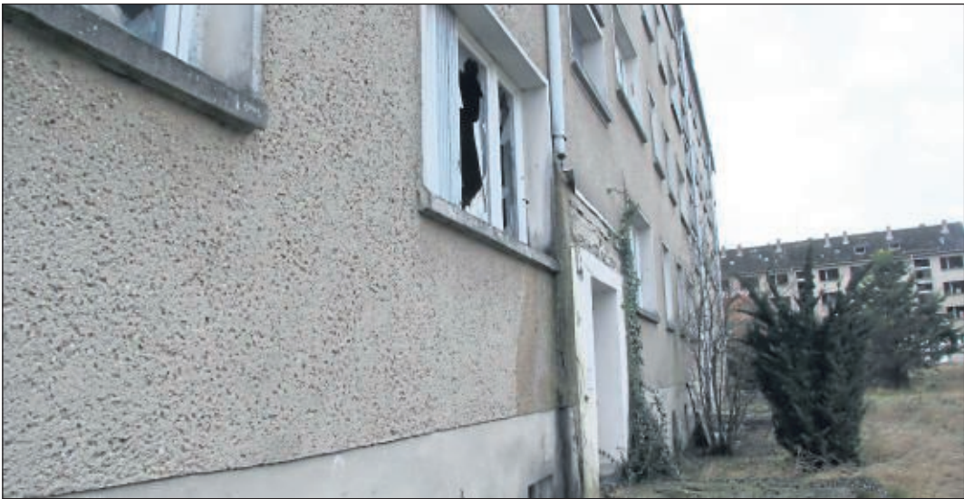
Diskussionen um leer stehende Wohnblöcke an Schul- und Ackerstraße sowie Dessauer Worth gibt es seit Jahren. Der Besitzer kündigte gegenüber der AZ an, 2018 sanieren zu wollen. Foto: Ziem
