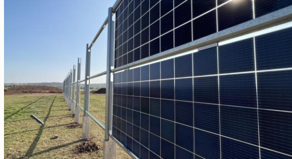
Bifaciale, senkrecht aufgeständerte Module Pilotanlage Heide Hof
